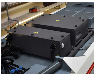
Nový statický měnič SMTK 22 a stykačová skříň jsou upevněny přesně v místech původních kontejnerů. (foto: Libor Hinčiča)
